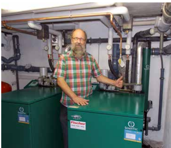
Simple, robust und hocheffizient – Daumen hoch für das Blockheizkraftwerk im Keller.
