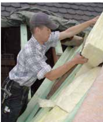
Eine gute handwerkliche Ausführung kann Fehler bei der Dachdämmung vermeiden.
