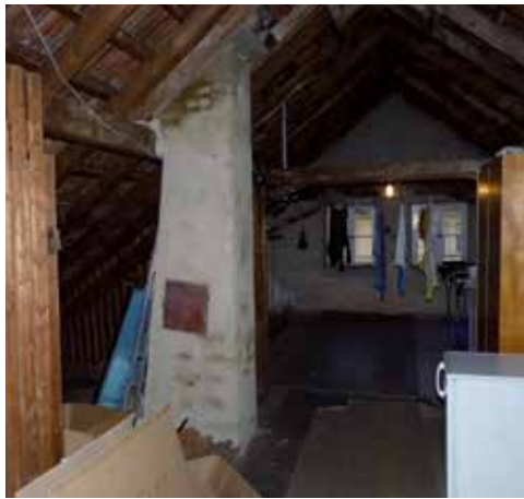
Am Anfang der Sanierung stand das Problem eines undichten Daches.
